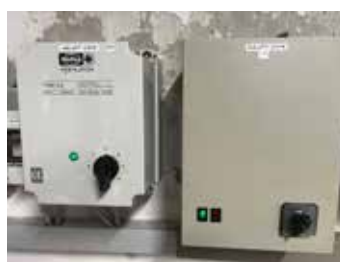
Lüftungschalter im unteren Abstellraum
